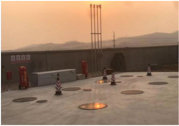
汽柴油储罐区
