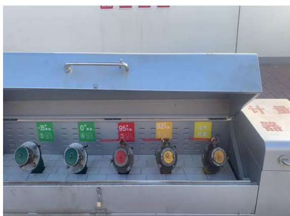
卸油油气回收
