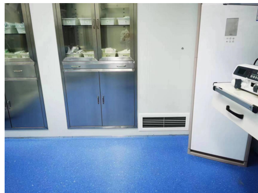
照片 6 DSA 手术室排风系统
