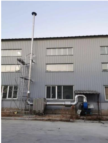
切割烟尘废气处理装置
